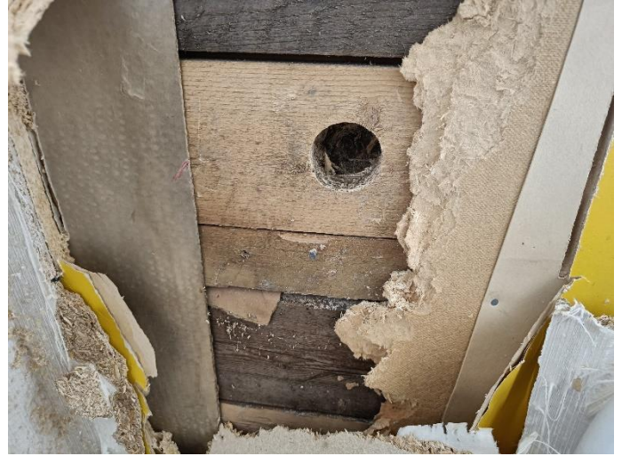
Kuva 16. Rakennevaigus RA10 lähempää kuvattuna.
