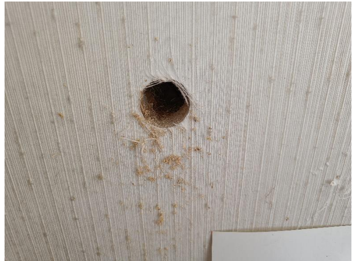
Kuva 20. Rakennevaigus RA11 lähempää kuvattuna.
